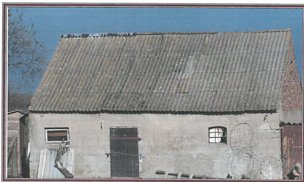
Rys. 8. Budynek gospodarczy pokryty płytą falistą azbestowo-cementową zlokalizowany w Gminie Świecie (źródło: własne).
