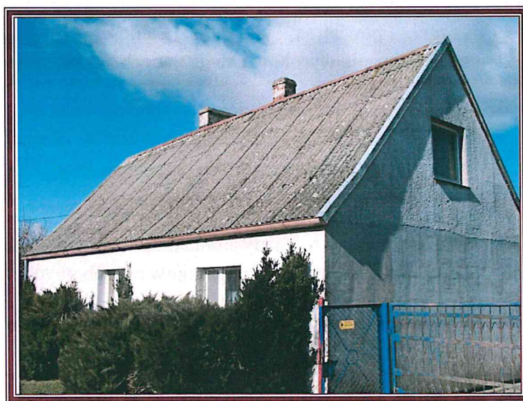
Rys. 3. Budynek mieszkalny pokryty płytą falistą azbestowo-cementową zlokalizowany w Gminie Świecie (źródło: własne).
